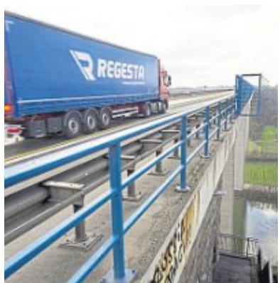
Die sanierungsreife Moseltalbrücke der A 61 wird für einen Tag voll gesperrt. Foto: Thomas Frey/dpa
